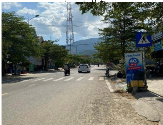
Hiện trạng đường bê tông nhựa
